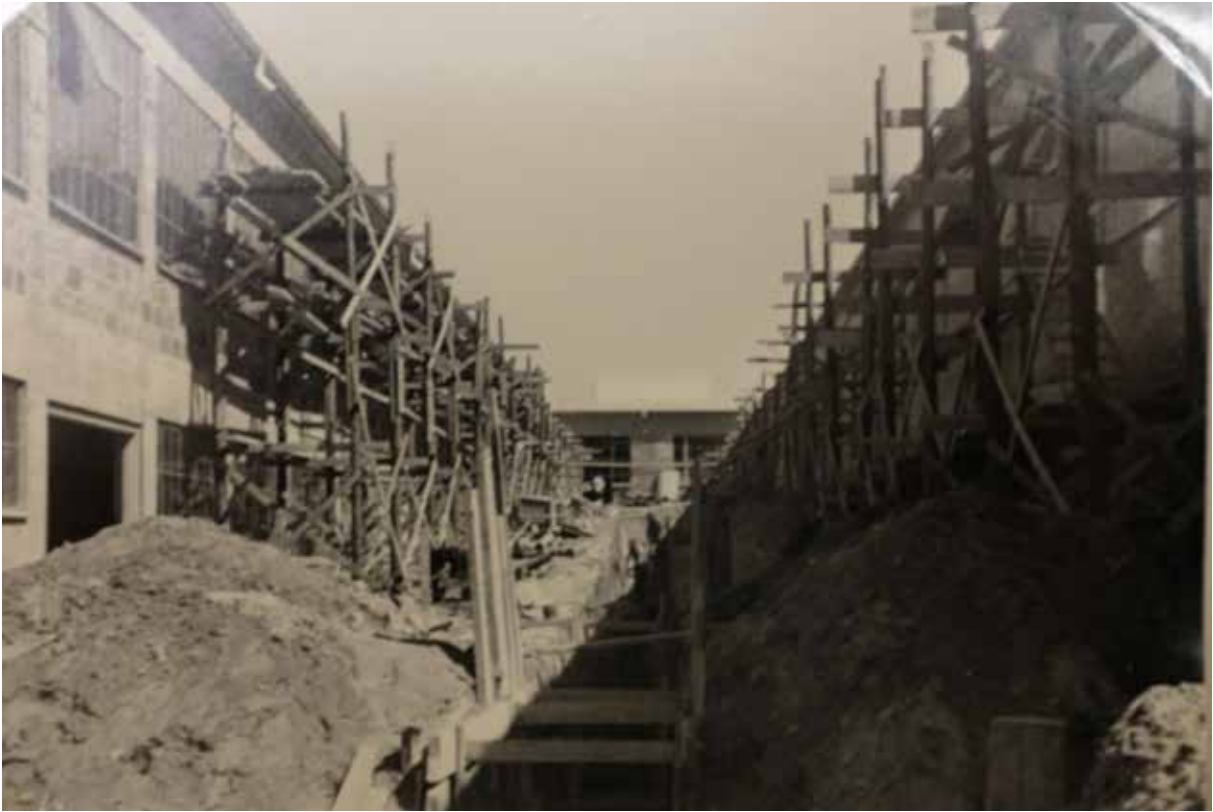
NEFA-anläggningen under uppbyggnad, bilden visar gården mellan de två södra flyglarna. Notera att bottenvåningen består av gjuten betong och att första våningen har väggar av mursten, troligen lättbetong.
