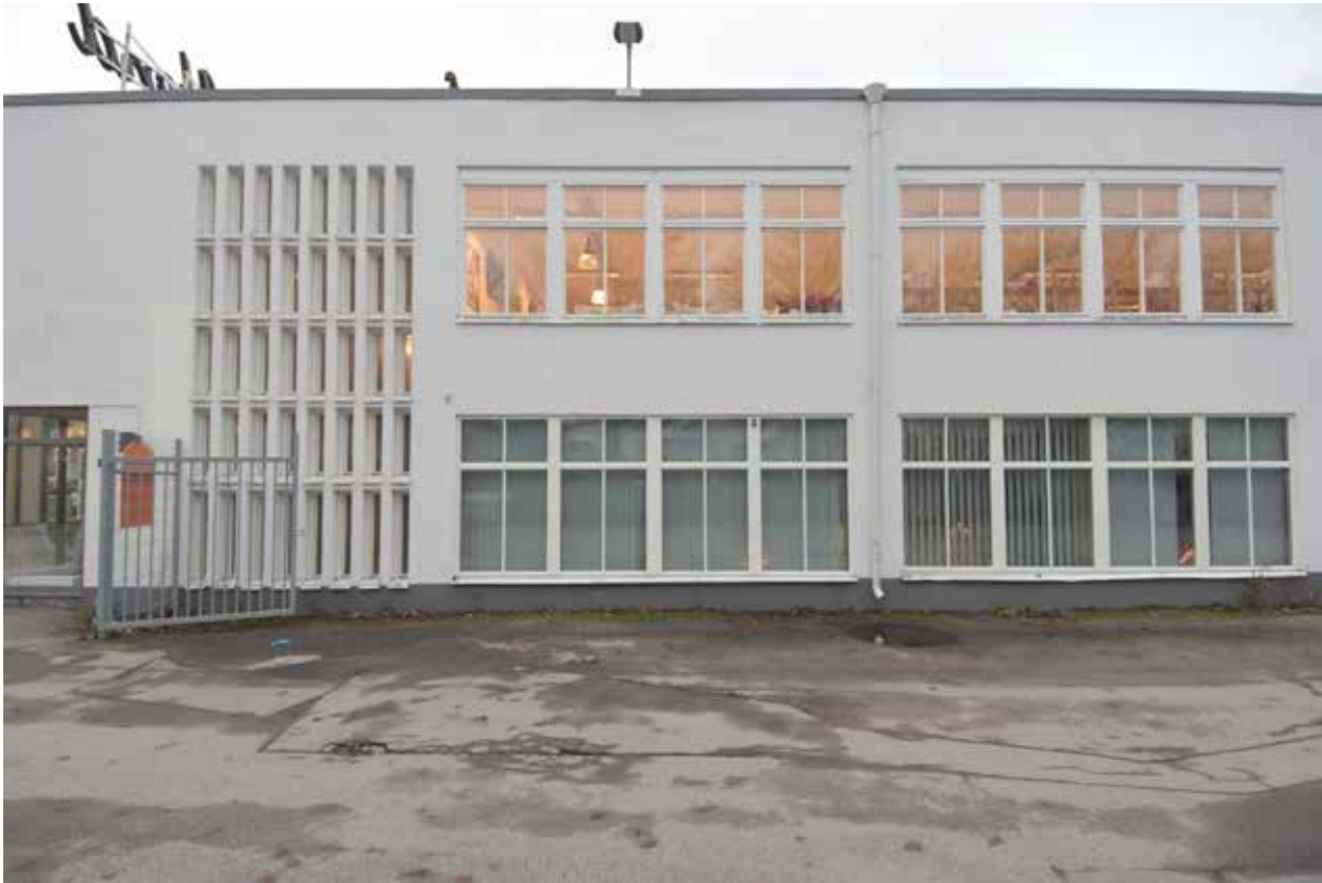
Fasad mot Finspångsvägen. Troligen är fönstren ursprungliga på övre våningsplanet, och förändrade nedtill.
