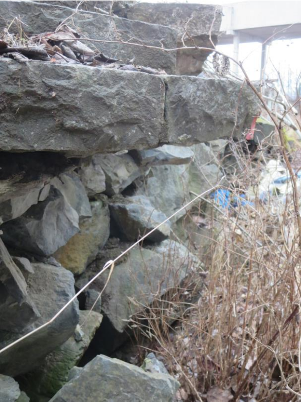
Figur 7. Saknade trappsteg och grundläggning. Foto från platsbesök 2023-02-16.
