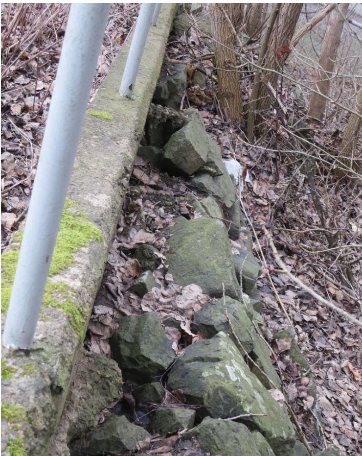
Figur 23. Sprängstensfyllning med lösa block. Foto från platsbesök 2023-02-16.
