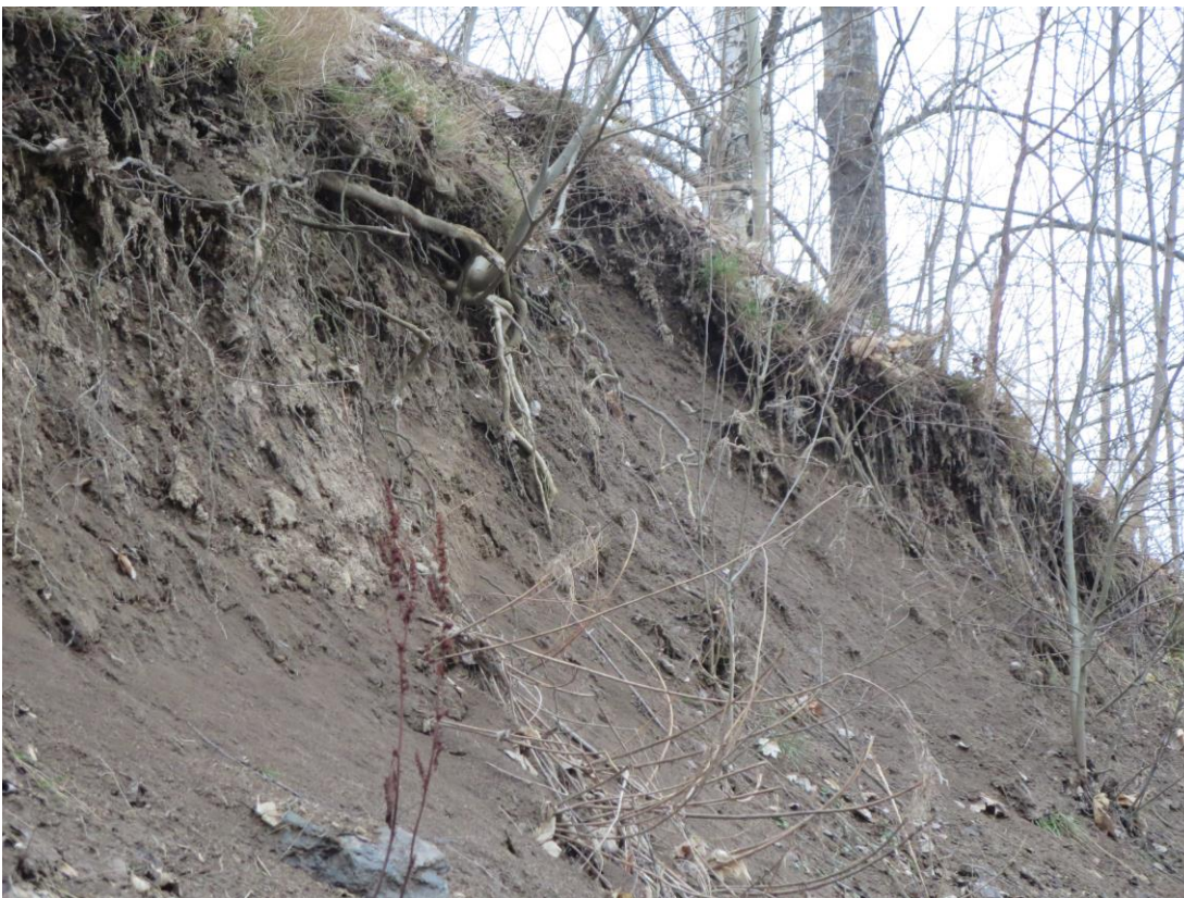
Figur 22. Pågående erosion i slänt. Foto från platsbesök 2023-02-16.
