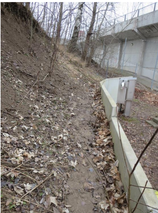
Figur 5. Bakom stödmur vid slänt i nordost. Stödmur saknar skyddsräcke. I bakgrunden syns fotbollsarenan. Foto från platsbesök 2023-02-16.
