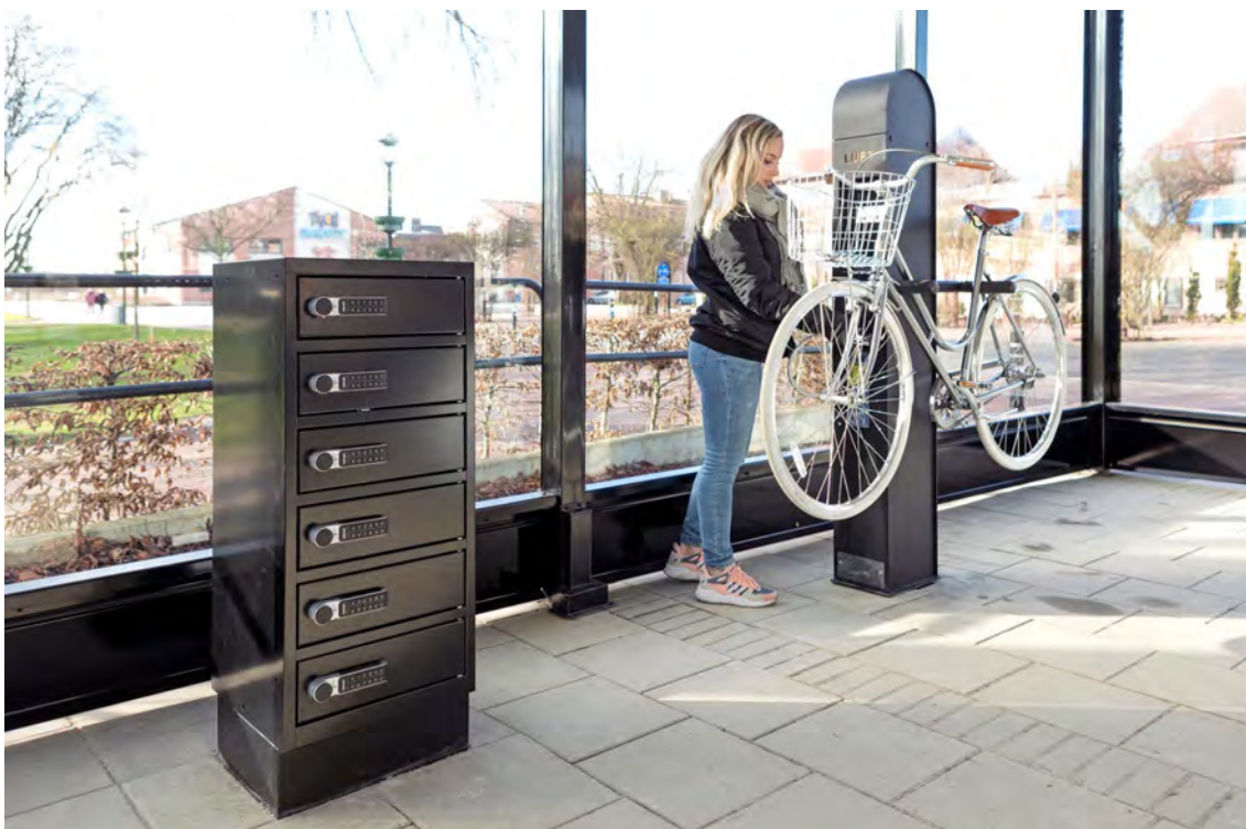
Figur 6 Exempel på låsbart laddskåp för cykelbatterier samt cykelservicestation. Bildkälla: cyklos.se
