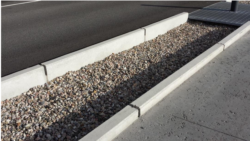
Figur 19 Exempel på större ränna/kanal som är krossfylld.
