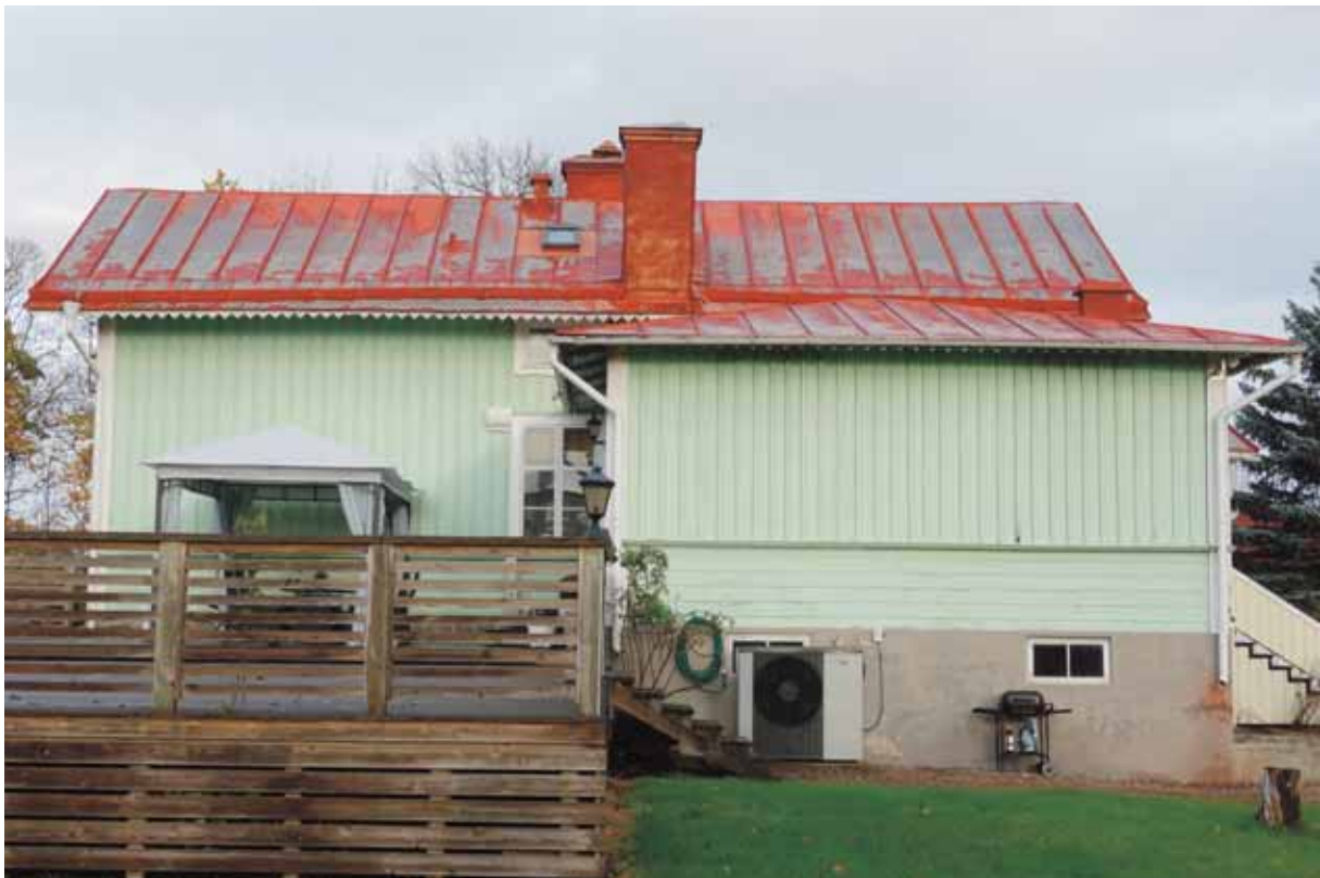
Byggnadens tak och skorstenar är täckta av bandsalsad plåt där målningen släpper.
