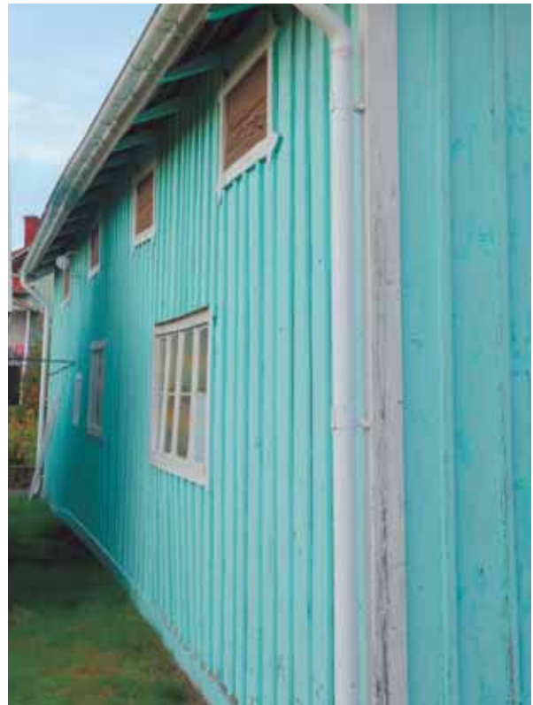
Byggnadens långsida mot väst, vägglivet buktar utåt något. Byggnaden har äldre fönster.
