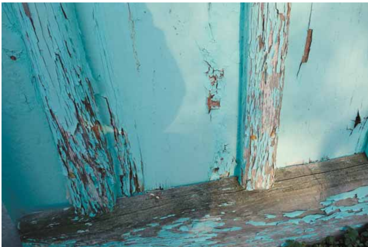
Ekonomibyggnadens fasad mot väst, bakom krackelerad färg syns panelen som rödbrun och lockläkten har varit vitmålad, spikarna i panelen är av allt att döma handsmidda.
