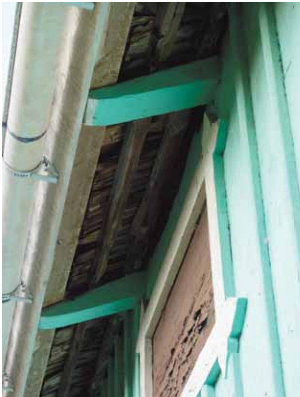
Ekonomibyggnadens tak är av äldre typ med enkla taktassar och därovan är taket täckt av spån.
