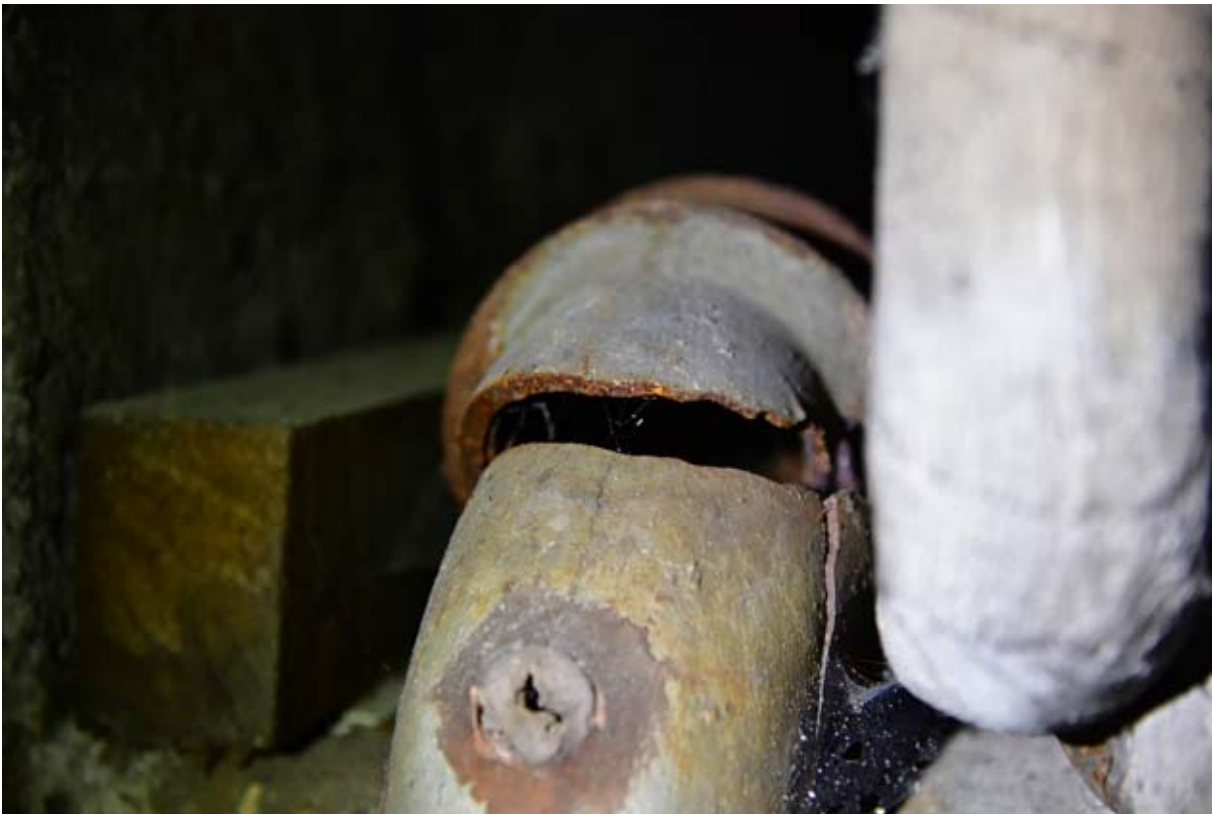
Flera äldre installationer är i dåligt skick, såsom VA och värmesystem.
