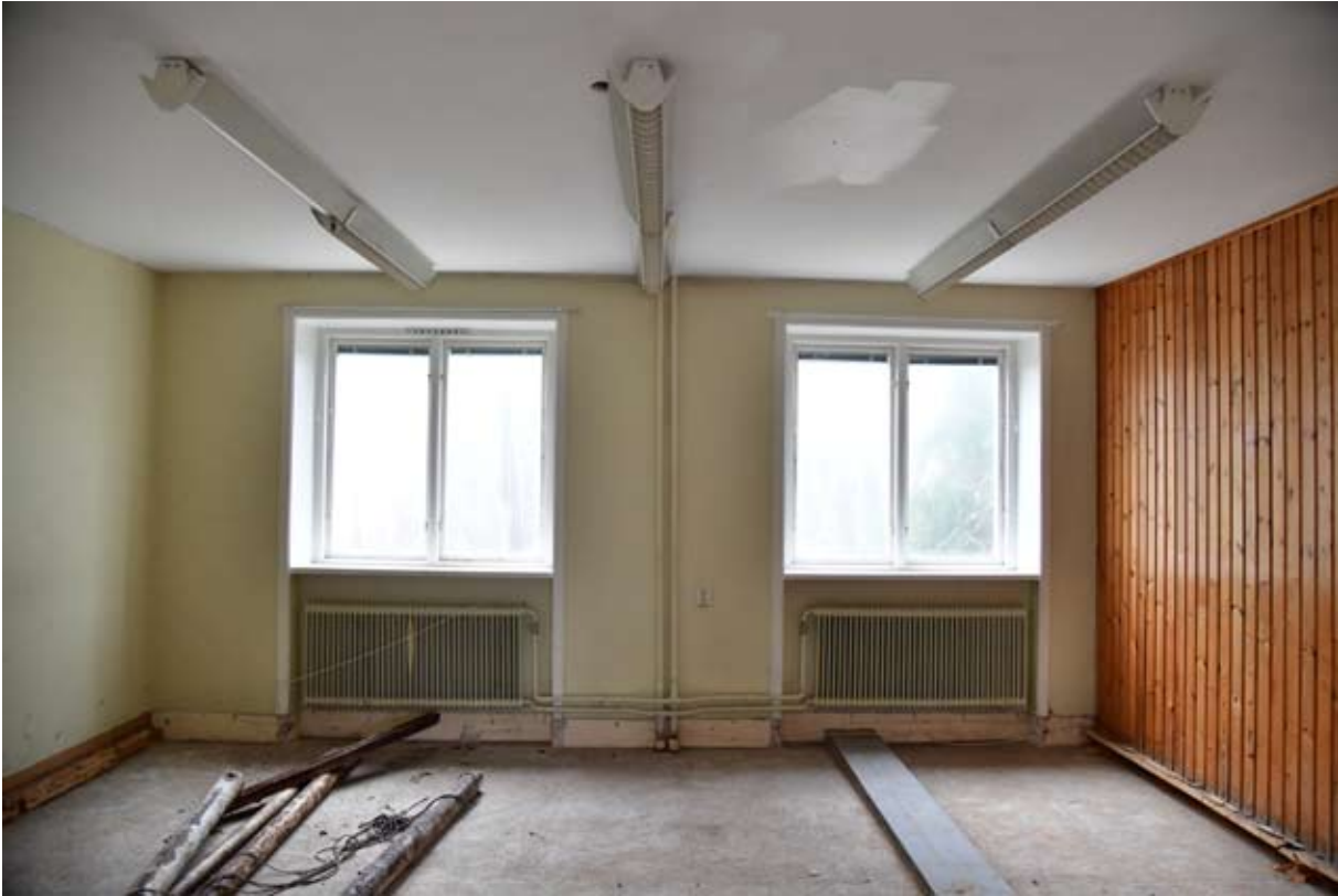
Interiör från bottenvåningen med äldre radiatorer. Sentida lysrörsarmaturer i taket.
