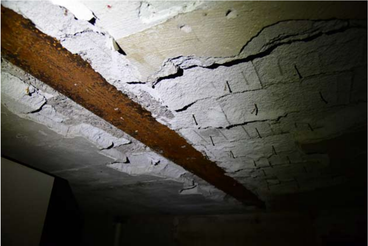
Detalj av tak i källaren. Taket har klätts med spikade "pannkakor" av gasbetongsiporex och sedan putats. Gasbetongen, som fungerat som isolering, har dock skadats i samband med en vattenskada och fallit ned. Stommen bedöms dock, trots viss ytrost på balken i bild, i tämligen gott skick.
