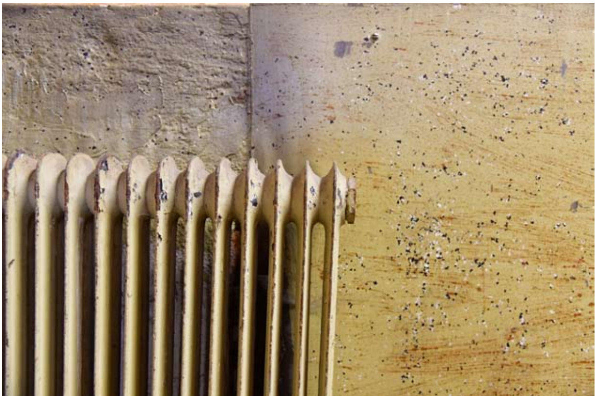
Detalj av sektionsradiator och flingfärgsmålade ytskikt i garaget
