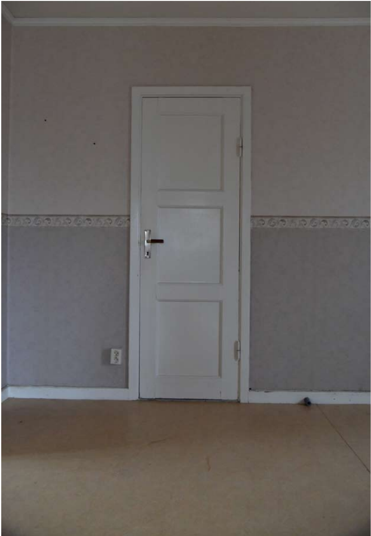
Tidig funkisdörr med bevarad beslagning. Foder och socklar av tidstypiskt slätt utförande.
