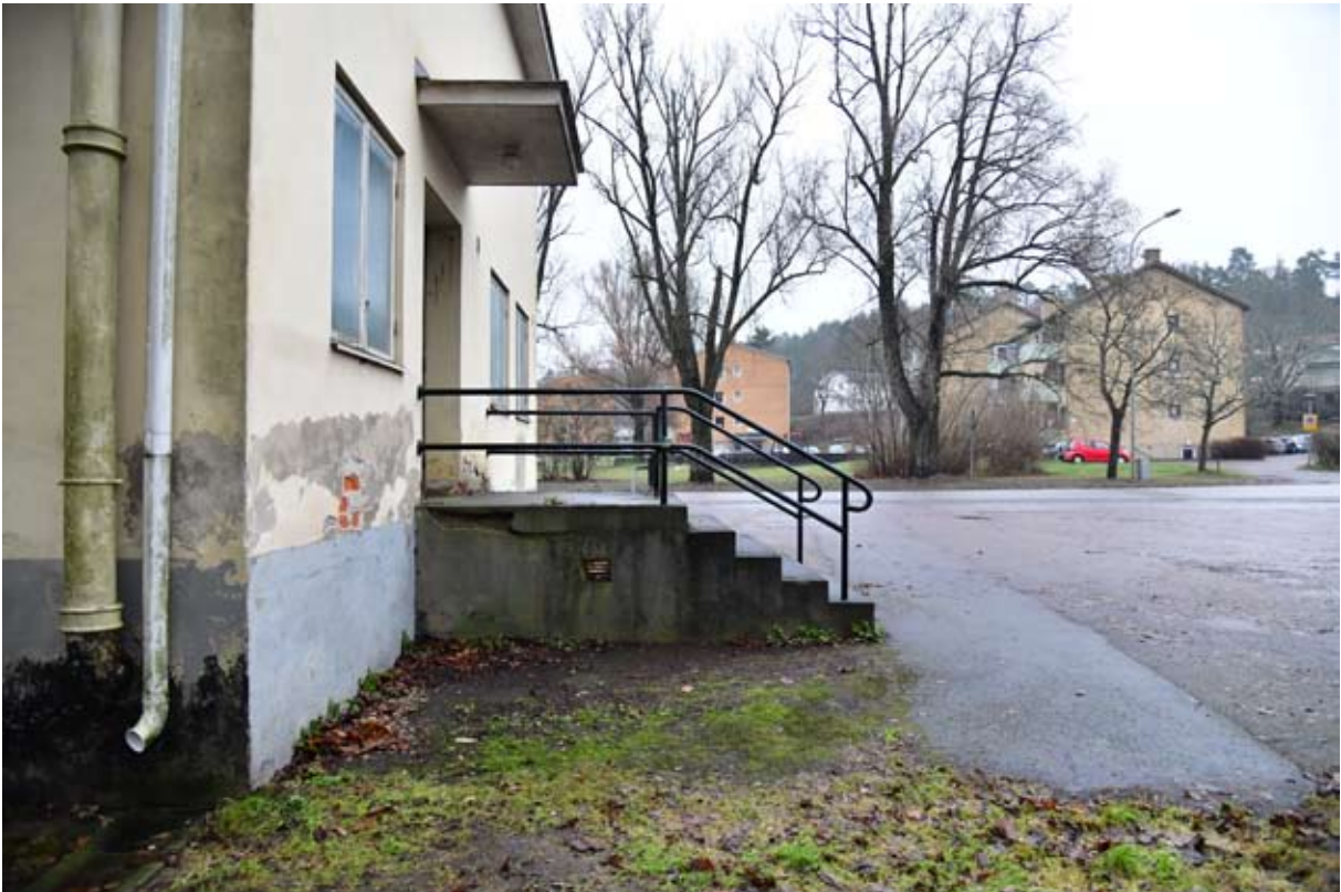
Entrétrappan på östra gaveln. Vid putsskadan syns att rött lertegel använts vid uppförandet av byggnaden. Räckan är mycket typiska för tiden. Sentiida takavvattning.
