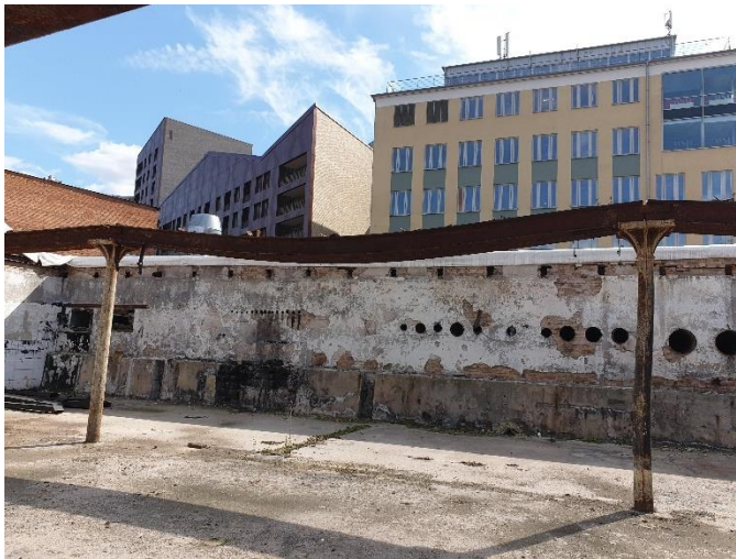
Bild 6. Primärbalk samt pelare av stål med synliga deformationer
