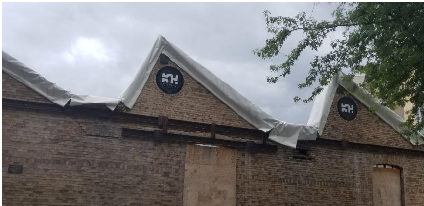
Bild 6. Västra fasaden, tydligt synliga skjuvningsprickor längsmed samt lokal skada vid balkupplag
