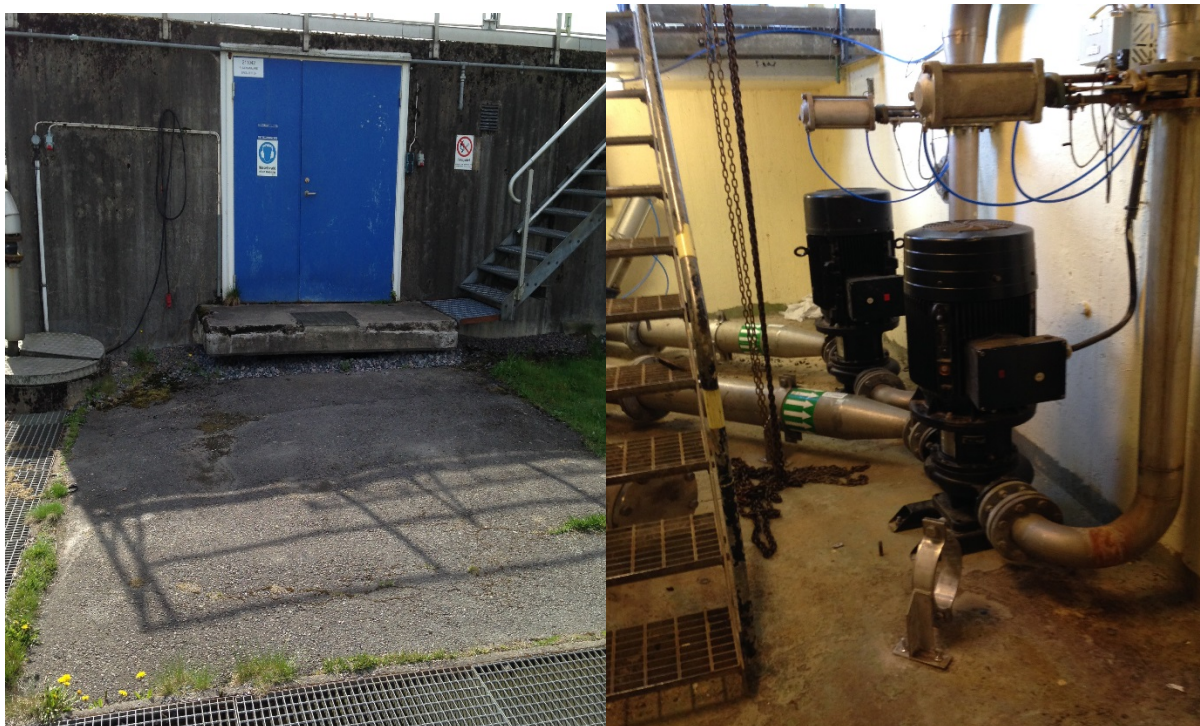
Figur 4. Översvämningsrisk vid dörrarna (vänstra bilden) som leder ner till pumpar och elutrustning (högra bilden) i spolpumprummet.
