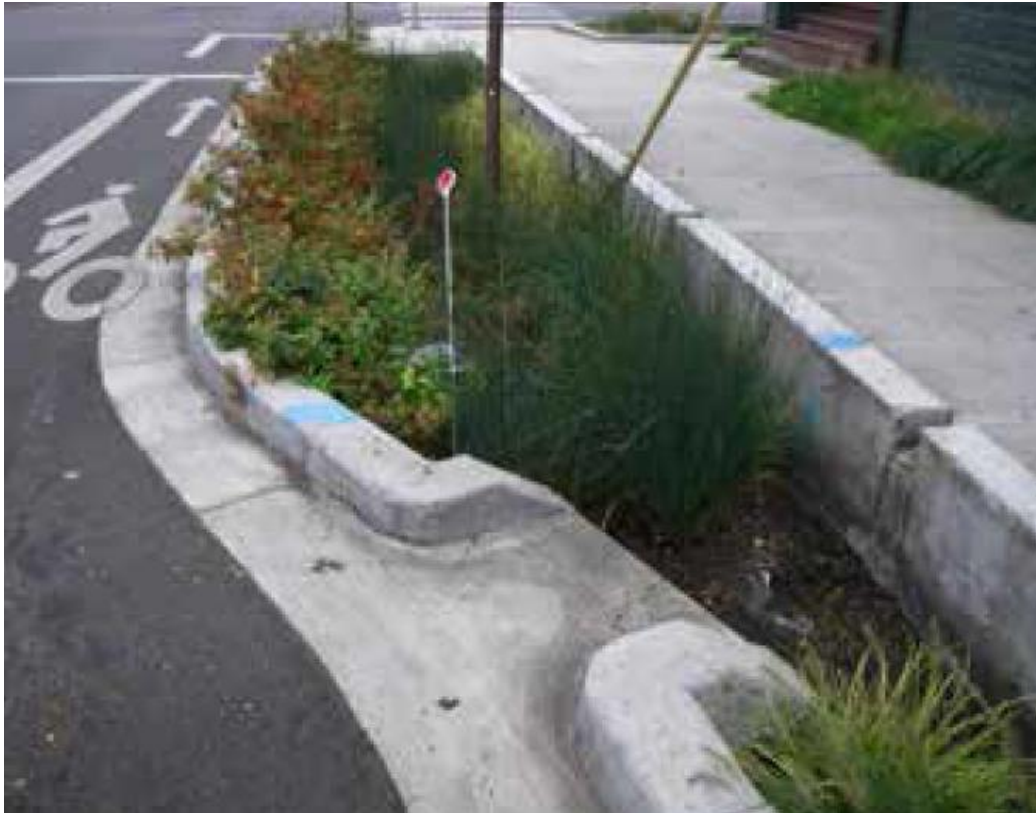
Figur 5. Regnbädd i anslutning till lokalgata (Uppsala Vatten)
