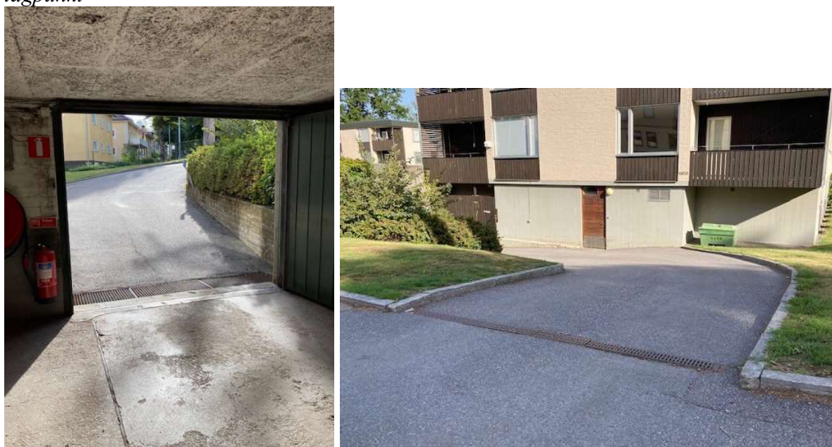
Figur 5 Risker vid område 2, Vatten kan gå upp bakvägen i dagvattenbrunnar och ränna samt rinna ner för garagednfarten om inte rännan har tillräckligt kapacitet
