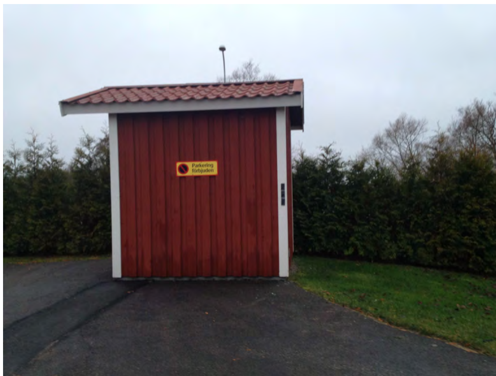
Figur 29. Exempel på lämplig utformning av den nya pumpstationen. Foto: Caroline Löfgreen Öhrn, november 2013 (pumpstationen på bilden finns in Ekängen i Linköpings kommun).
