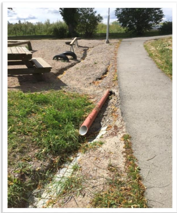
FIGUR 10. EN RÄNNA SOM GÅR LÅNGS LEKPARKENS SIDA. TILL VÄNSTER OM LEDNINGEN PÅ BILDEN SYNS DEN EROSIONEN SOM BILDATS AV DAGVATTEN.
