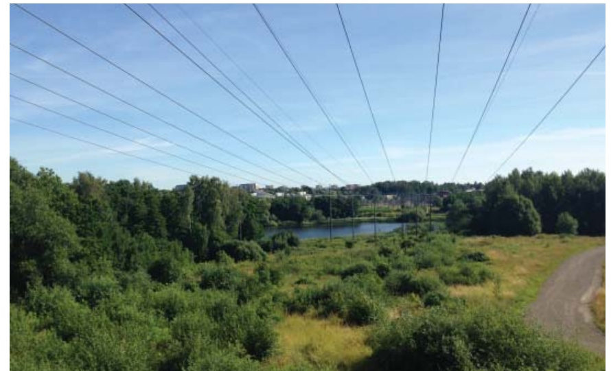
Kraftledningar går rakt igenom området.
